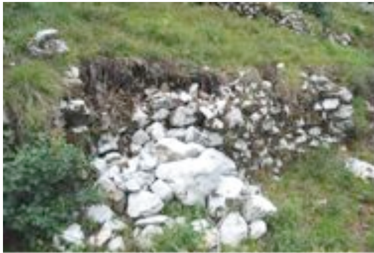
c. Degrado strutturale di un muretto
