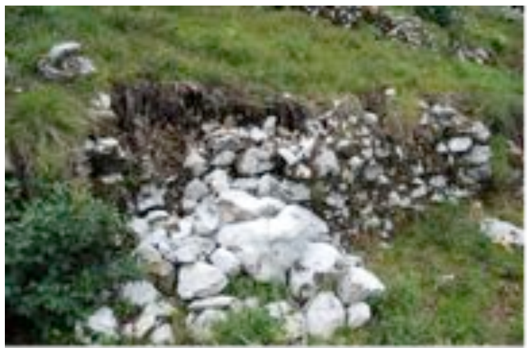
Fig. 35: esempio di crollo di parte dell'edificio murario in area terrazzata conseguente a degrado strutturale ed a fenomeni di ripristino dell'originaria morfologia del versante (Pascoli, Comune di Sospirolo, Belluno).
