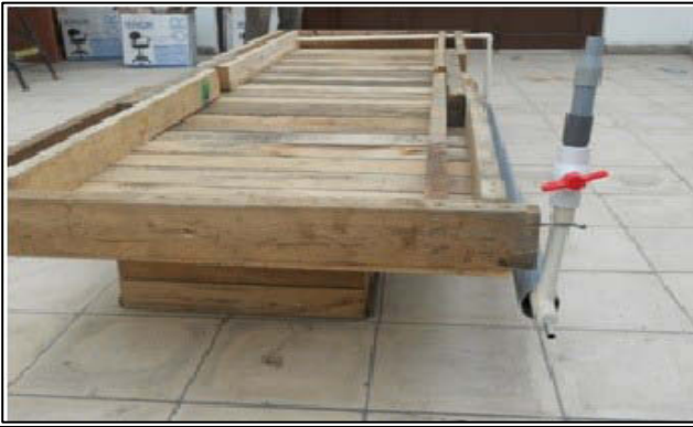
Struttura di sostegno della serra solare in legno
