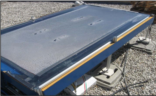
Canali di ricircolo dell'aria
