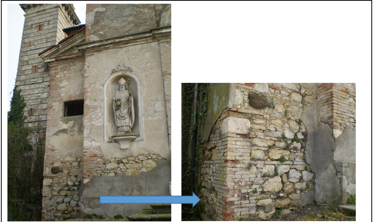
Fig.5 Pieve di S.Giustina, facciata angolo N-O. Nel particolare si nota la mesa in posa di materiale lapideo malamente sbazzato
