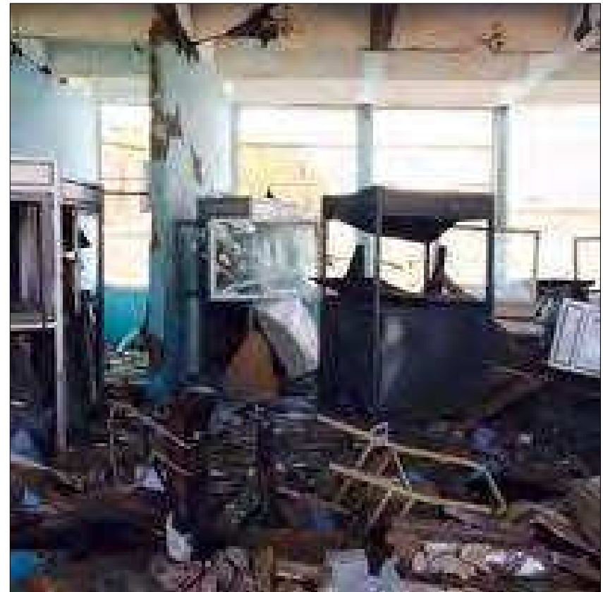
B – Danneggiamenti nel nuovo Museo Islamico di Ghazni (2014; A. Yar).
