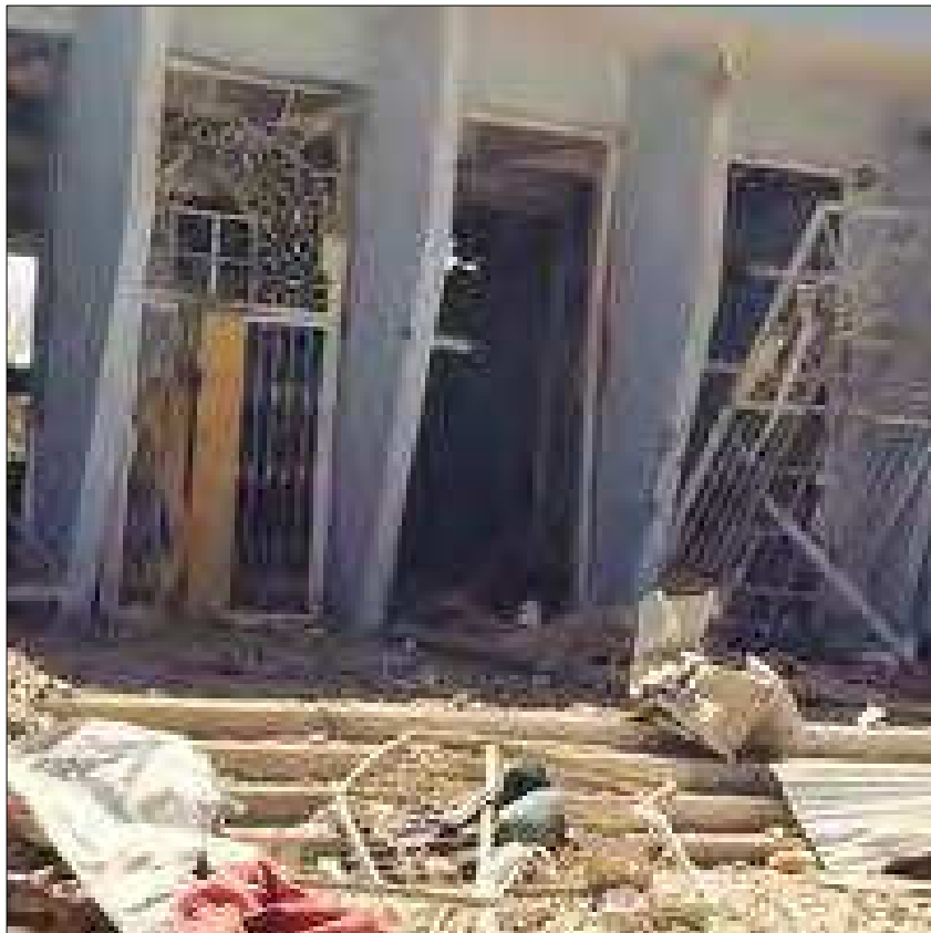
A – Danneggiamenti nel nuovo Museo Islamico di Ghazni (2014; A. Yar).
